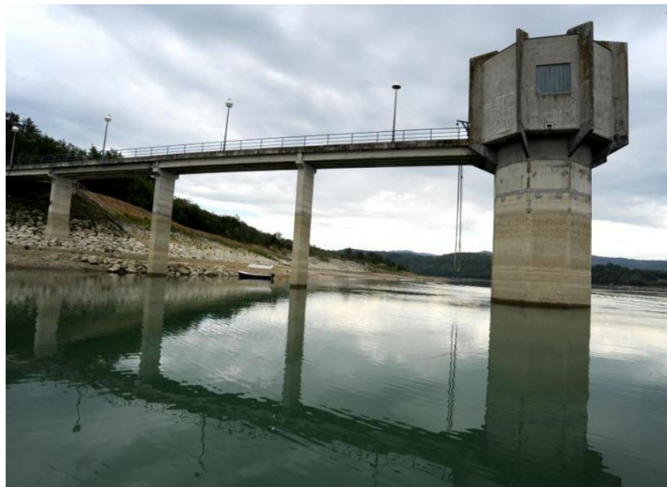
Vodozahvat na Butonigi, vodoopkrsbni sustav Istre
